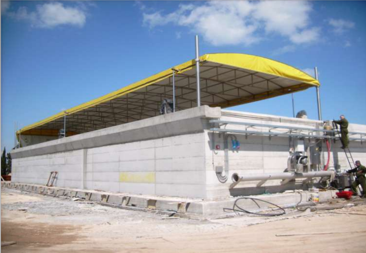
Impianto di biostabilizzazione frazione umida RSU – Contrada Codavolpe – Catania: vista dell'aia di stabilizzazione aerobica
