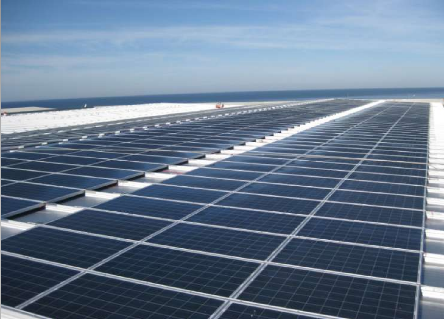
Impianto fotovoltaico C.da Feudo Orsa – Cinisi (PA): vista dell'impianto ultimato
