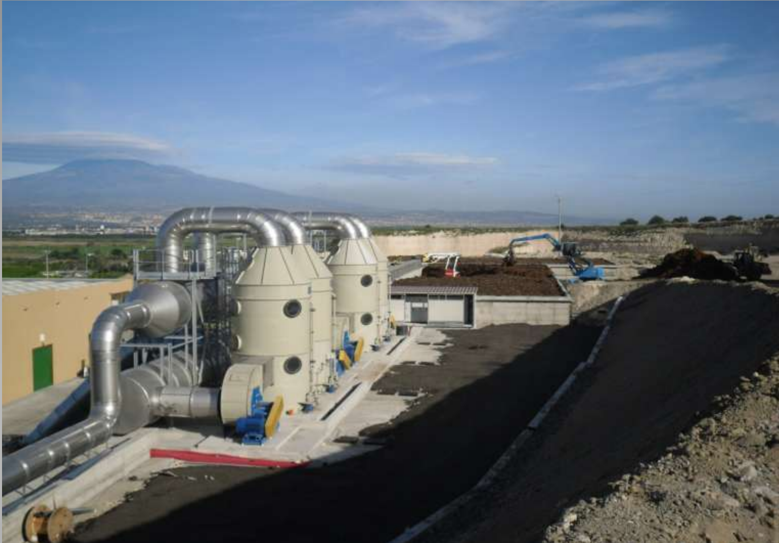
Impianto di selezione e trattamento di RSU – Contrada Codavolpe – Catania: vista dei sistemi di trattamento aria (scrubber e biofiltro)
