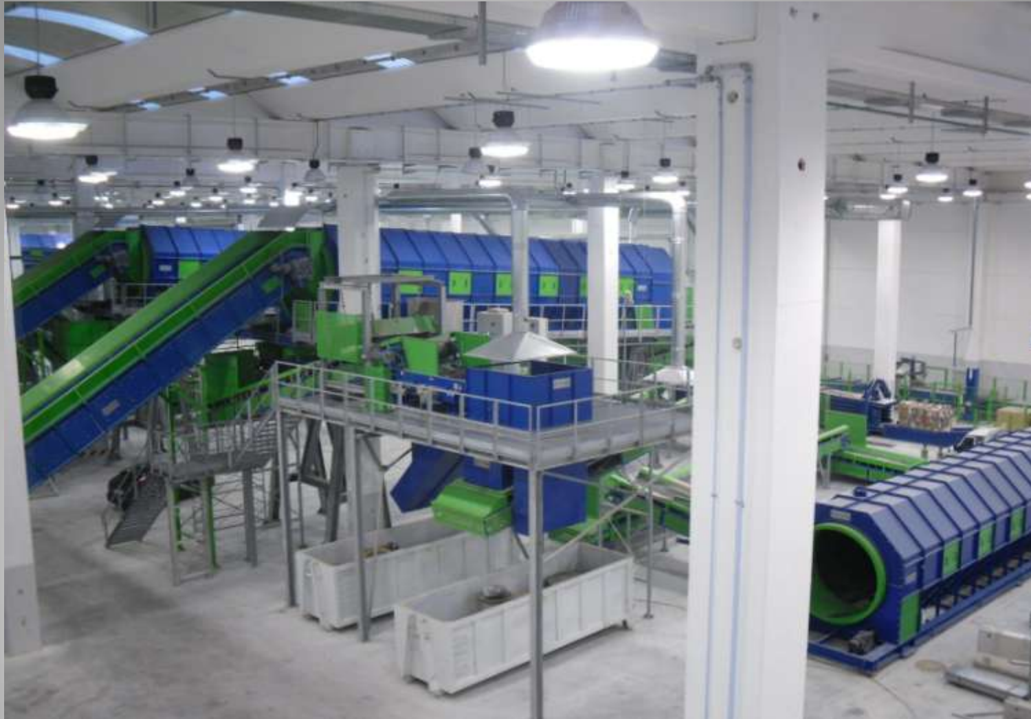
Impianto di selezione e trattamento di RSU – Contrada Codavolpe – Catania: vista interna
