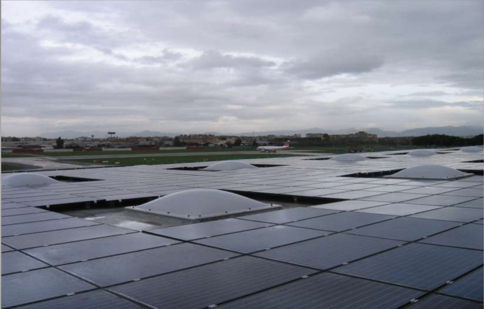
Impianto fotovoltaico Casoria (NA): vista dell'impianto ultimato
